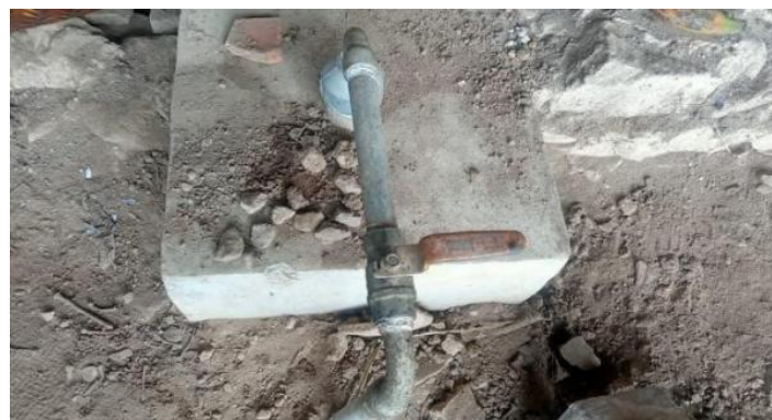
Gambar 6. Kran penghubung gas.
