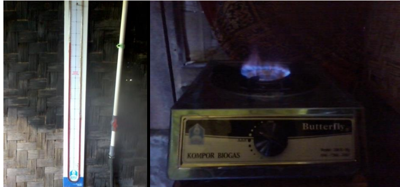
Gambar 5. Indikator tekanan dan kompor biogas
