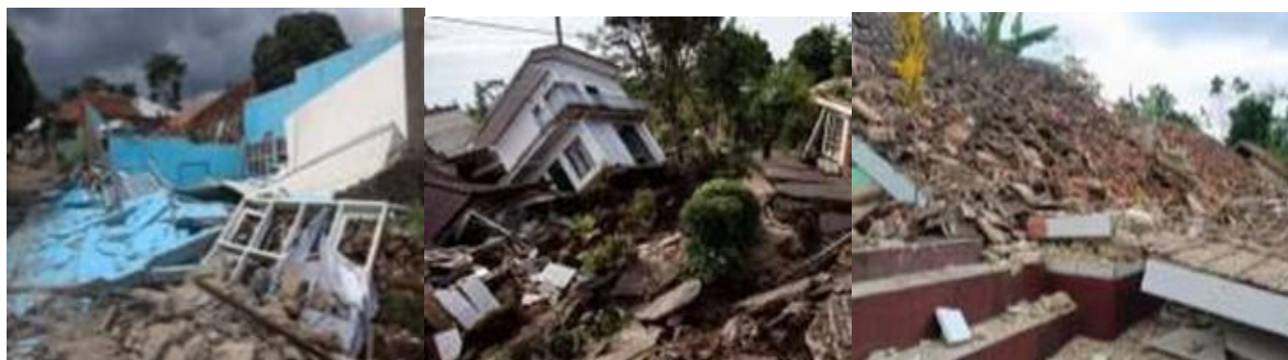
Gambar 3: Kondisi rumah yang hancur akibat gempa bumi di Desa Nagrak tahun 2022 Sumber: Dokumentasi, 2022
