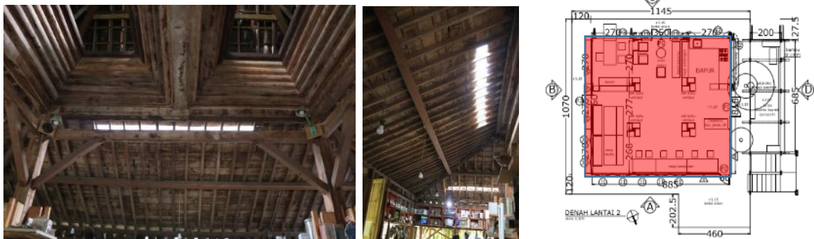
Gambar 18 Material Langit-Langit Area Kerja Utama Studio Akanoma (Sumber: Data Studio Akanoma & Data Pribadi)
