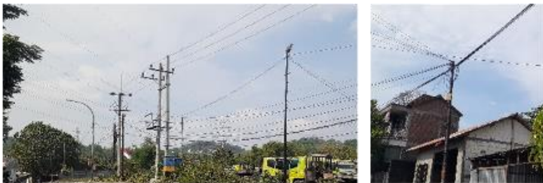
Gambar 9. Jaringan Kabel Telepon di Kawasan Wisata Religi Desa Giri
