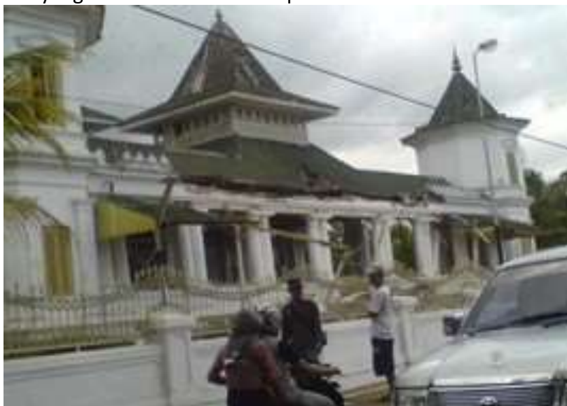
Gambar 7. Kondisi Masjid Manonjaya Rusak Akibat Gempa Bumi Tasikmalaya, 2010 (Sumber: Narasumber, 2021)
