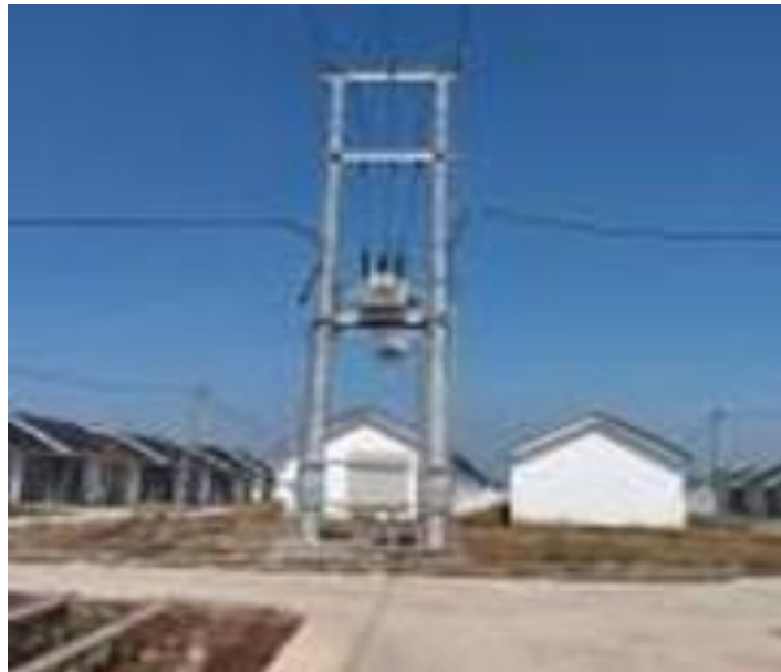
Gambar 19. Gardu Listrik (Sumber:Dokumentasi Pribadi, 2024)
