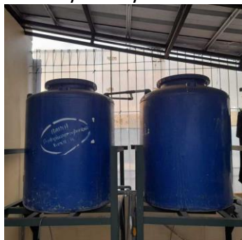
Gambar 16. Tangki Air Kosan di Kosan Maysa Raiya No. 87
