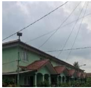
Gambar 9. Jaringan Listrik Perumahan Pussenarhanud (Sumber: Dokumentasi Pribadi, 2024)
